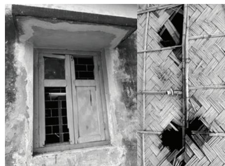
Bâtiment délabré du foyer garçons
